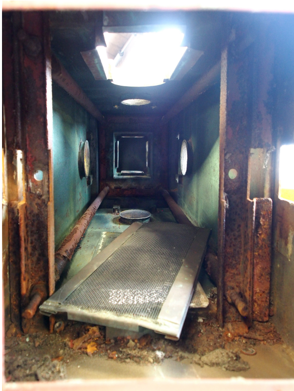
Abb.8: Einsicht von unten ins Innere des Türmchens, mit der stark verrosteten Eisenkonstruktion.
